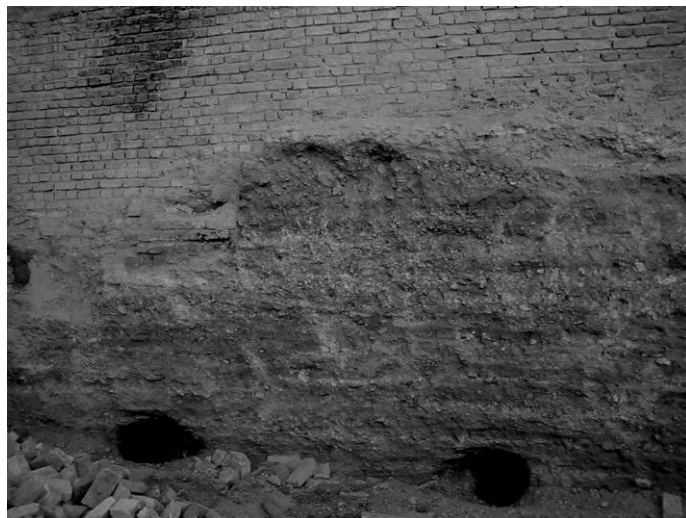
شکل ۱-۱: وجود حفرات در زیر بناهای موجود و در حال احداث در تهران
