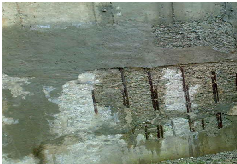
شکل (۱-۱) - تراوش آب از بدنه مخازن بتنی
