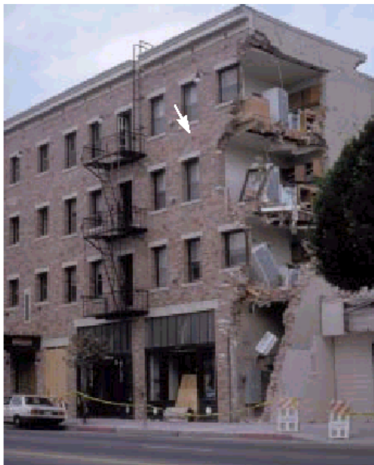
شکل ۲-۲ : خسارت به دیوار خارجی ساختمان، چنانکه ملاحظه می شود بی توجهی به ایمنی دیوارهای غیر سازه‌ای می تواند منبع تولید خسارت باشد (زلزله لس آنجلس).
