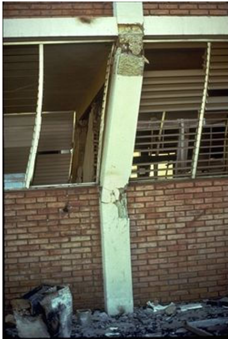
شکل ۲- ۸ : شکست برشی ستون به دلیل وجود دیوار میانقاب.
