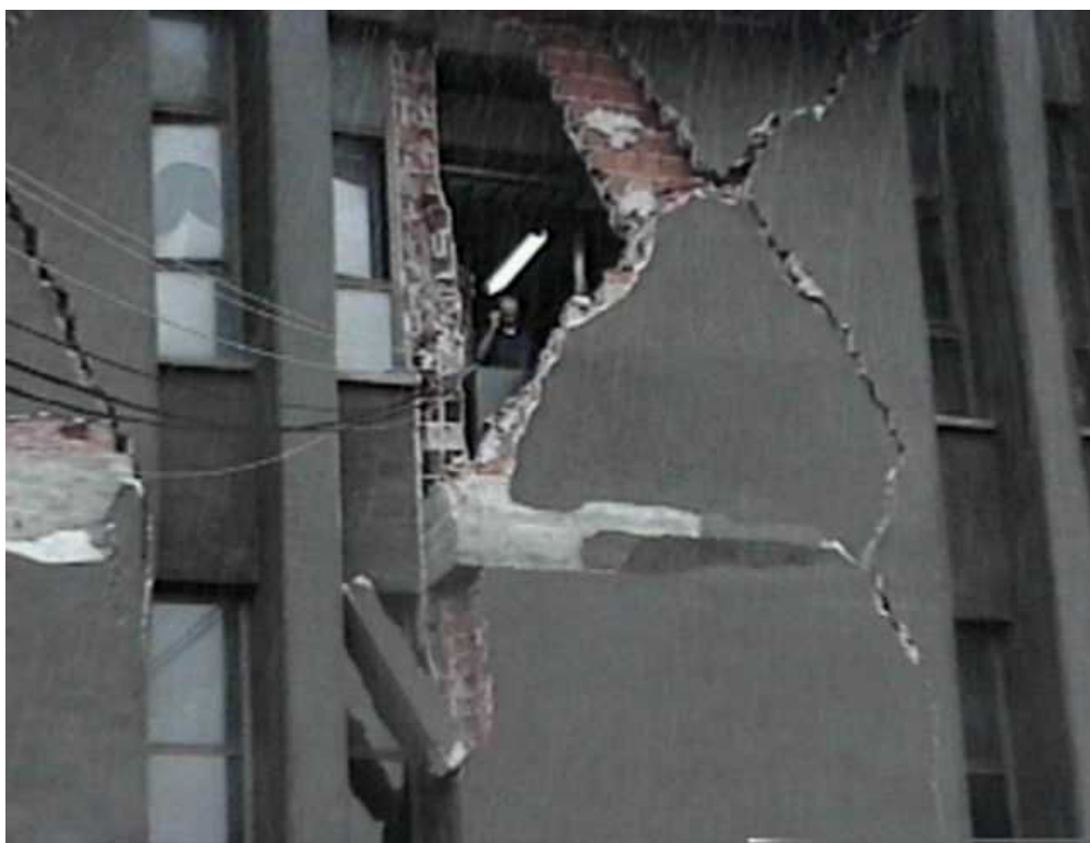
شکل ۱-۲: تخریب میانقابهای محیطی ساختمانی در زلزله ۲۰۰۳ ترکیه
