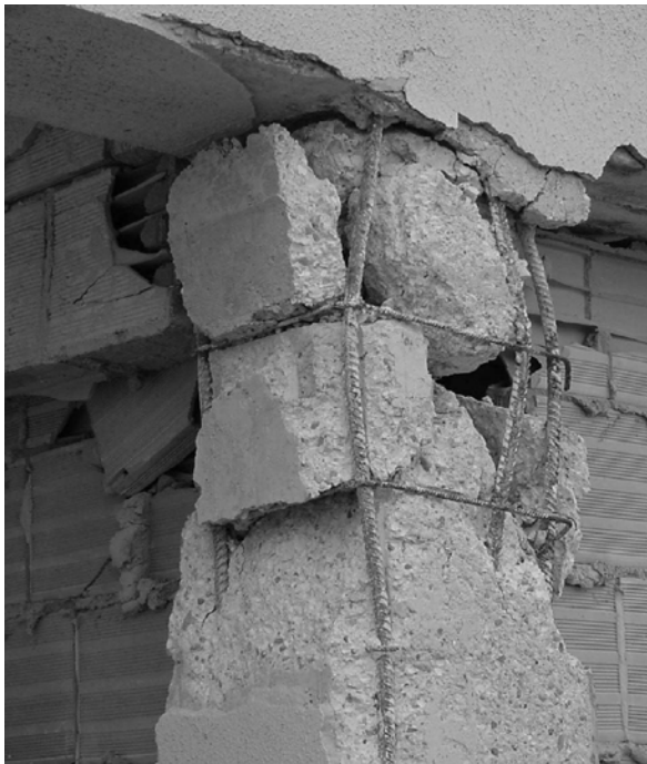
شکل (۷) : همان اتصال ستون بتنی شکل (۶) بعد از وقوع پس لرزه. [4]
