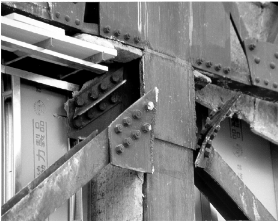
شکل (۵-۱): گسیختگی اتصالات جوشی بادبندها [۷]
