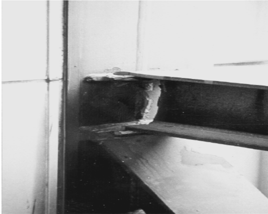
شکل (۱-۵): گسیختگی جوش [۱]
