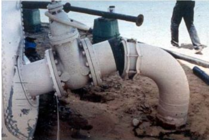
شکل 1-6 شکست یکی از لوله های متصل به مخزن
