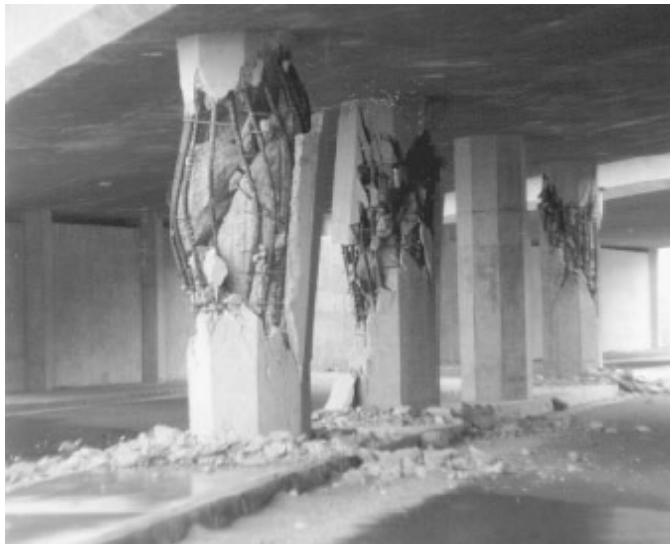
شکل (۱-۲): شکست برشی در ستون [۵]
