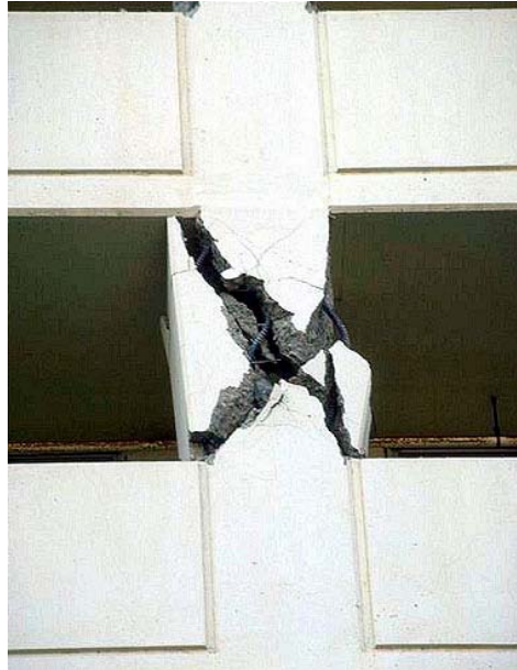
شکل (۳-۱): شکست برشی در ستون کوتاه در زلزله سال ۱۹۹۴ Northridge
