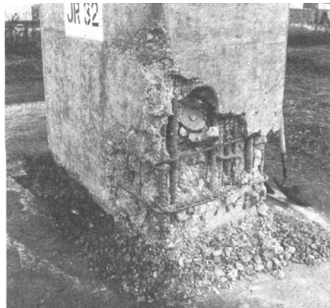
شکل (۴-۱): خرابی ستون به علت تخریب وصله پوششی [۵]
