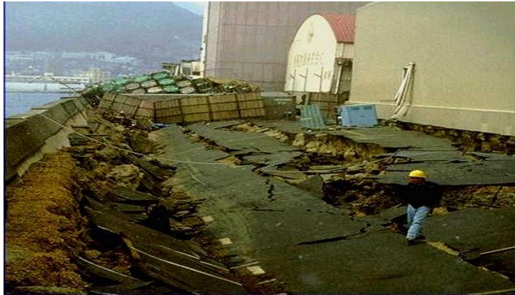
شکل (۸-۲): خرابی دیوار حایل بر اثر گسترش جانبی، کوبه ۱۹۹۵ [۱۰]
