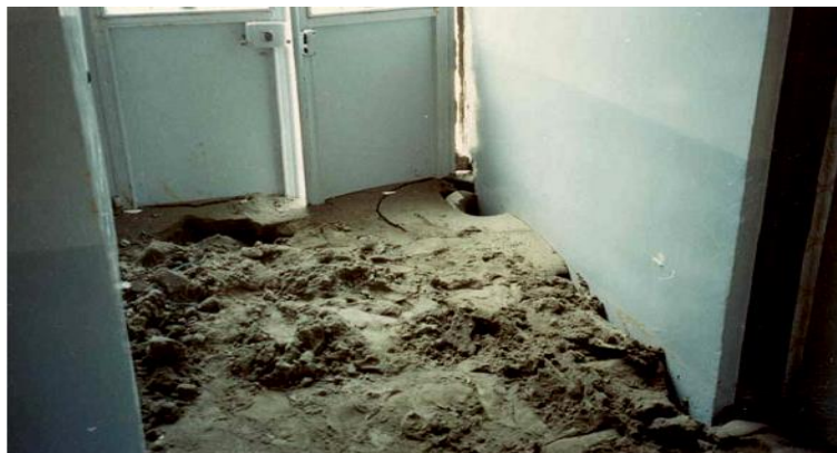
شکل (۹-۲): جوشش ماسه در کف خانه در آستانه اشرفیه، زلزله منجیل ۱۹۹۰ [۱۰]
