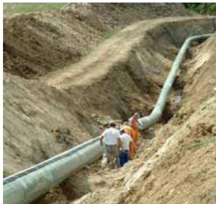
شکل ۷-۲- خطوط لوله گاز [۴].
