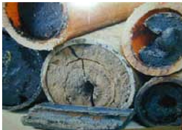
شکل ۱-۴ نمایی از گرفتگی لولها به علت رسوب آسفالتین [۳۷]
