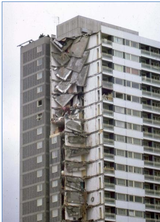
شکل ۱-۱- خرابی پیشرونده در ساختمان Ronan Point لندن سال ۱۹۶۸
