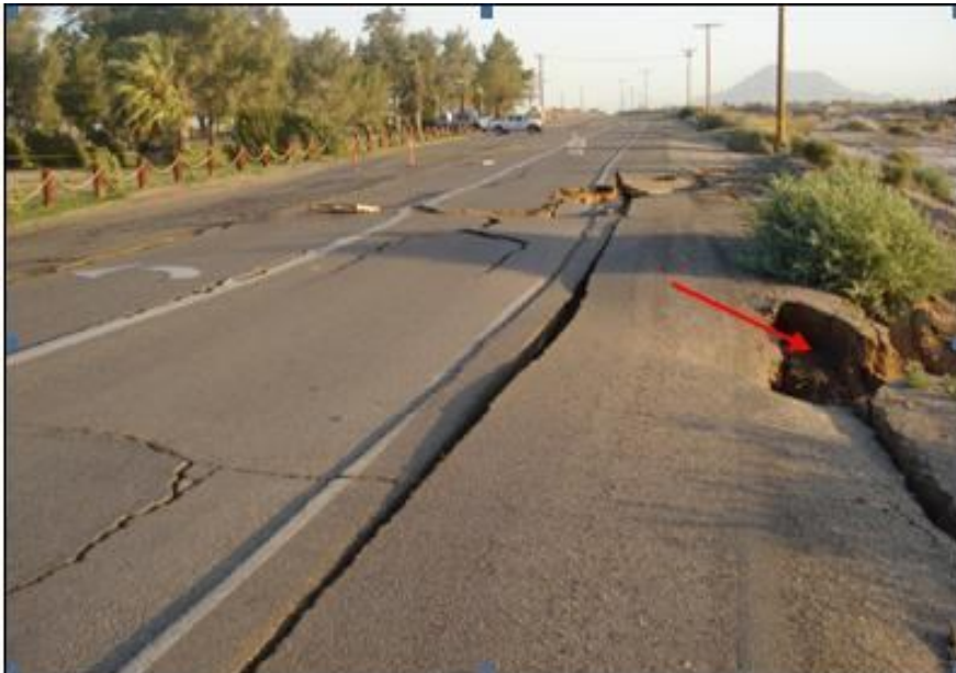
شکل ۱-۱- نشست سطح جاده به علت نشست‌های مفرط در بستر راه
