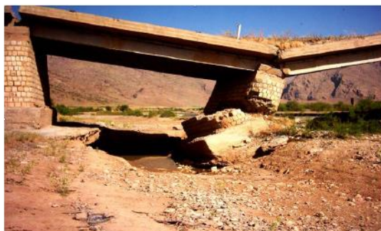
شکل (۱-۱): تخریب پایه پل در اثر آبستگي در چمچال کرمانشاه (سعیدی نژاد و همکاران، ۱۳۸۴)
