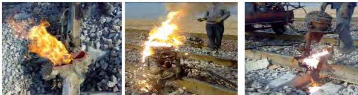
شکل ( ۲ - ۲۰) - مراحل جوش ترمیت از چپ به راست، پیش گرمایش ریل ، مشتعل شدن مواد جوش و مواد مذاب
