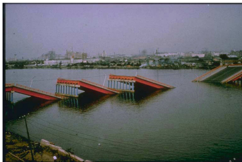
شکل ۱-۵: گسیختگی پل شوا
