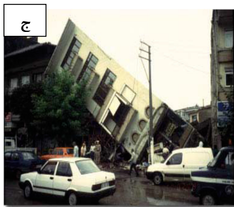
شکل ۱-۱: (الف) گسیختگی یک ساختمان مسکونی در زلزله بیوج هند (۲۰۰۱) - (ب) کج شدن ساختمان بلند در زلزله کوبه (۱۹۹۵) - (ج) کج شدن ساختمان در زلزله Koeceli ترکیه (۱۹۹۹)
