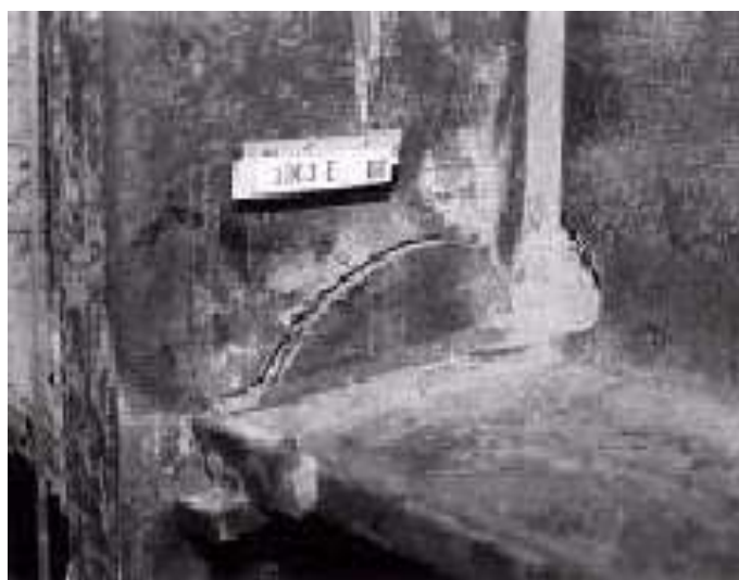
شکل ۴-۱: شکست بال ستون در طی زلزله نرتریج [۱]
