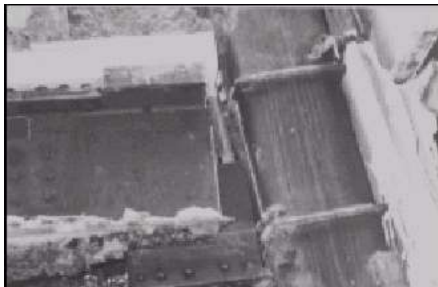
شکل ۸-۱: شکست کامل اتصال تیر به ستون در طی زلزله نرتریج [۱]
