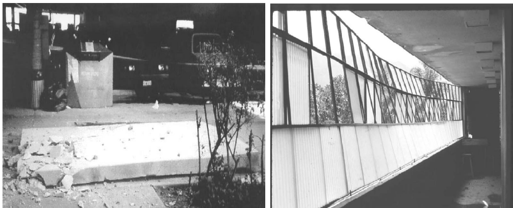
شکل 1-2: تصویر سمت چپ تخریب پنجره یک مدرسه در زلزله مکزیکوسیتی 1973 را نشان می‌دهد و تصویر سمت راست پنل پیش‌ساخته‌ای که سقوط آن منجر به مرگ یک دانش‌آموز در زلزله لسانجلس - کالیفرنیا 1987 شد. [23]
