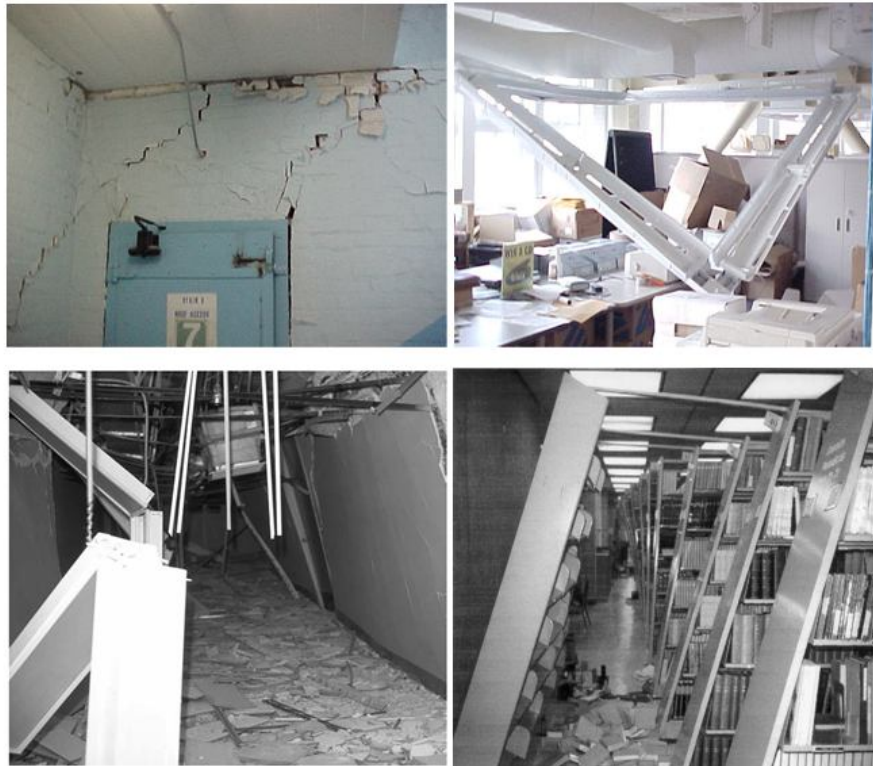
شکل 1-1: نمونه‌هایی از خرابی اجزای غیر سازه‌ای در زلزله. [25, 23]
