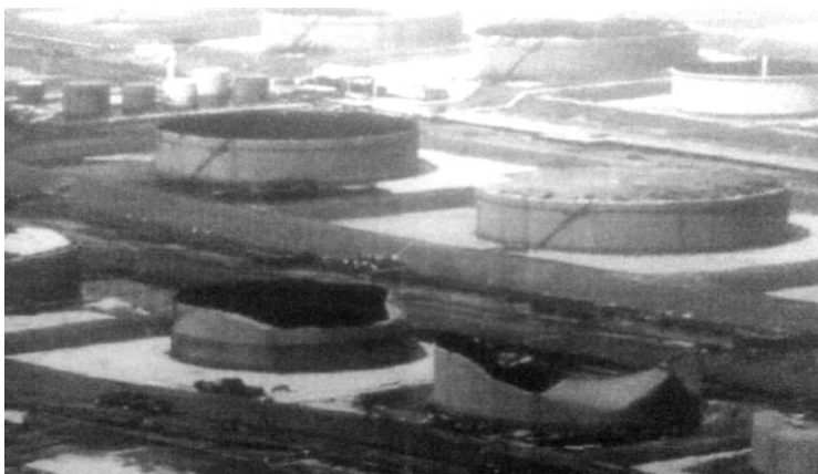
شکل ۱-۱ مخزن های تخریب شده در اثر گردباد کروایکس (۱۹۸۹) [۲]
