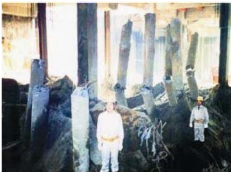
شکل ۱-۵- شکست شمع مشاهده شده پس از حفاری ساختمان NHK بعد از زلزله ۱۹۶۴ نیگاتا [۲]
