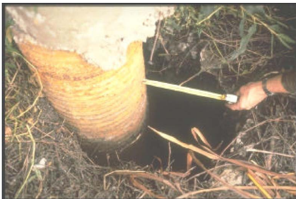
شکل ۷-۱- شکاف ایجاد شده بین شمع و خاک در بزرگراه استراو در اثر زلزله لوماپریتا [۷]
