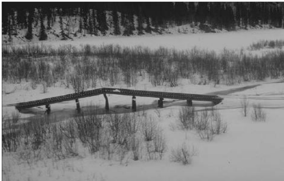
شکل ۱-۶- خم شدن یک پل راه آهن در زلزله ۱۹۶۴ آلاسکا در اثر شکست شمع های زیر پایه پل [۷]
