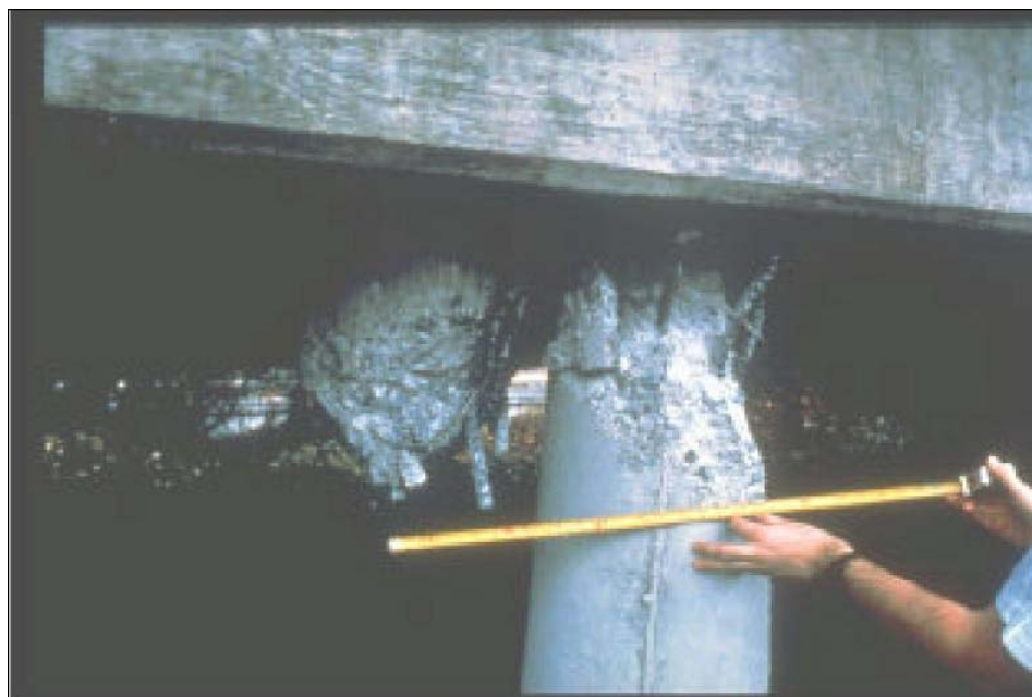
شکل ۸-۱- گسیختگی برشی سر شمع در بزرگراه استراو در اثر زلزله لوماپریتا [۷]
