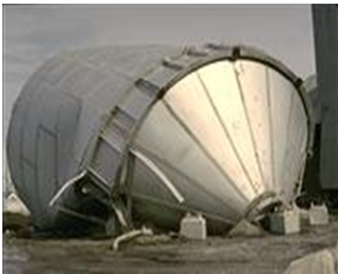
شکل ۲-۵- سقوط مخزن فولادی هوایی [۶]
