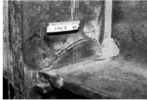
الف) شکست در ناحیه جوش
