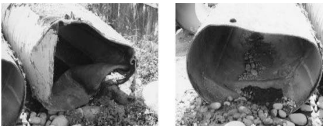
شکل ۱-۳ خسارات وارد به لوله‌های مدفون در زلزله‌ی Chi-Chi (تایوان ۱۹۹۹) [۵]
