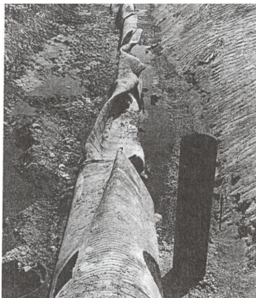
شکل ۱-۱ خط لوله‌ی زهکشی، آسیب دیده در زلزله‌ی Northridge (۱۹۹۴) [۳]
